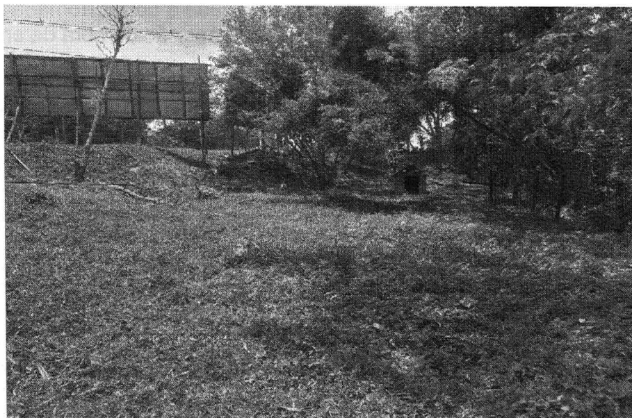
Foto n.º 8 – Ao fundo desta foto (tirada a partir do interior da propriedade particular), está a avenida, depois da placa. Nesta posição da placa (que também pode ser vista na Foto n.º 25) já se notam os problemas de fissuras no pavimento. O relevo que se percebe, sempre pela informação do munícipe, foi obra de aterro à época da pavimentação da Av. Subtenente Luiz Gonzaga de Toledo Araújo
