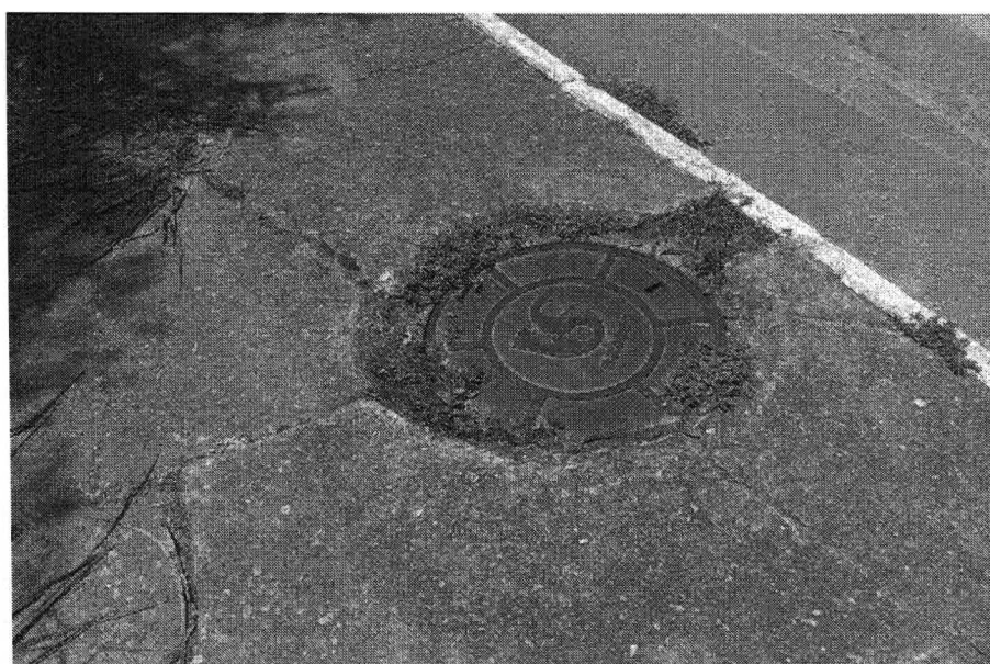
Foto n.º 23 – Detalhe do PV comentado na foto anterior. Na eventualidade de ocorrer uma infiltração, isso torna preocupante quanto à estabilidade do talude.
