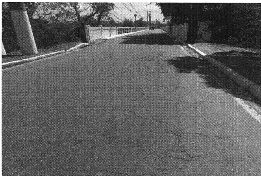
Foto n.º 18 - Aspecto do pavimento na chegada da ponte. Trincas interligadas disseminadas pela superfície. Formações localizadas de patologias designadas “couro de jacaré”.
