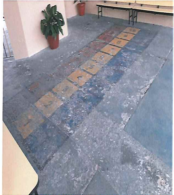
PISO DE CONCRETO ANTES DA MANUTENÇÃO (05/09/2019 - 14:10)
