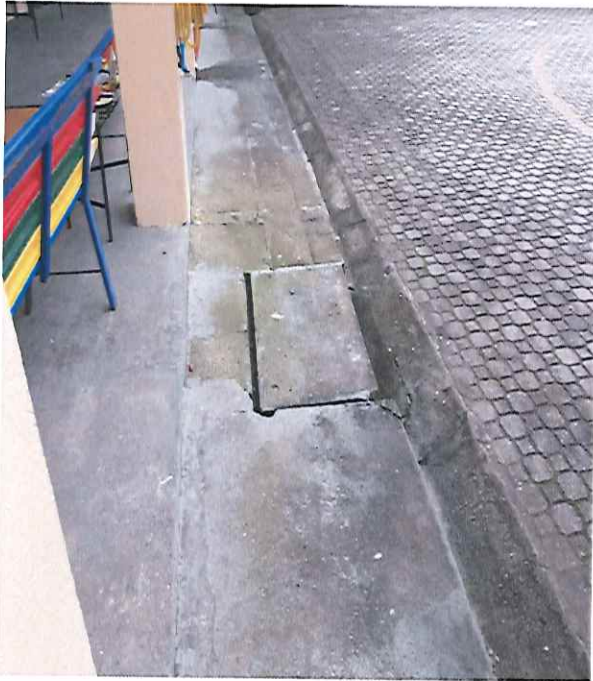
PISO DE CONCRETO ANTES DA MANUTENÇÃO (05/09/2019 - 14:00)
