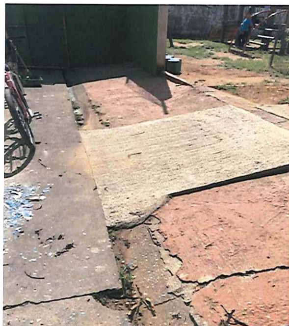
PISO DE CONCRETO ANTES DA MANUTENÇÃO ( 05/09/2019 - 15:47)
