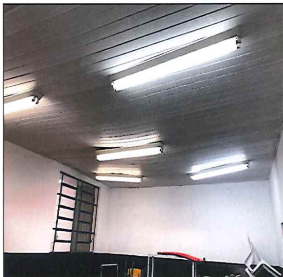
FOTO 03: VISTA DE FORRO EMPENADO E PINTURA DESGASTADA ANTES DA EXECUÇÃO DO SERVIÇO. 19/07/2019 - 14:32
