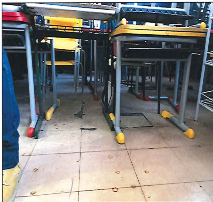
FOTO 02: VISTA DE PISO DANIFICADO ANTES DA EXECUÇÃO DO SERVIÇO. 19/07/2019 - 14:33
