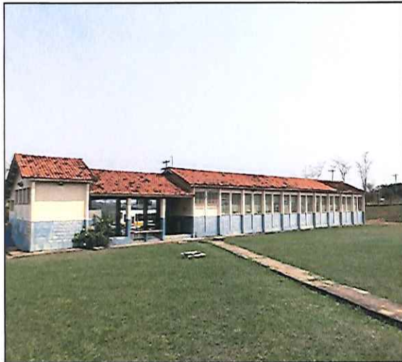
FOTO 01: VISTA DO PRÉDIO APRESENTANDO NECESSIDADE DE PINTURA. 19/09/2019 - 11:28
