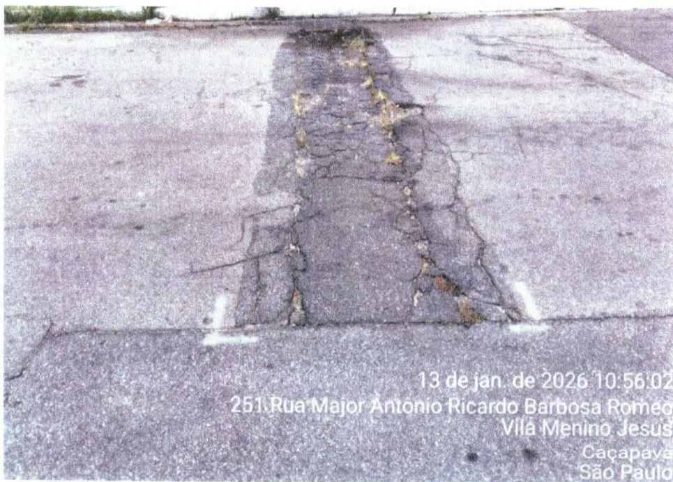
Foto 4: Deslocamento e fissuração do reparo realizado
