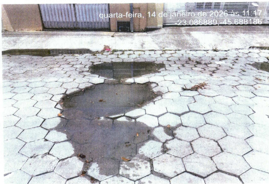
Foto 16: Local com afundamento na via em frente ao hidrômetro Rua Regente Feijó, 18, Vila Santos, Caçapava – SP Tel. (12) 3652-5909 | secretaria.obras@cacapava.sp.gov.br
