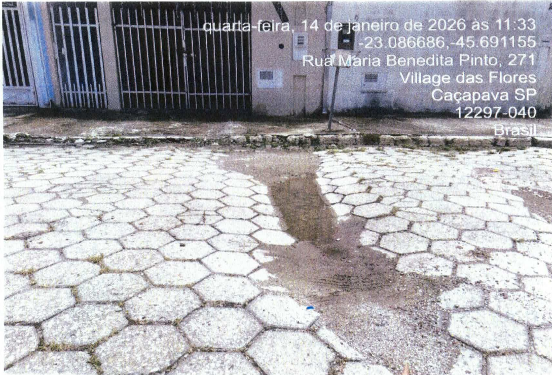
Foto 23: Local com afundamento na via em frente ao hidrômetro
