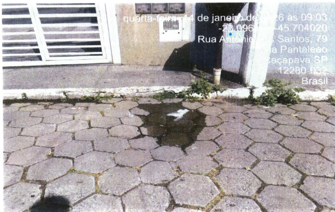
Foto 11: Local com afundamento na via em frente ao hidrômetro
