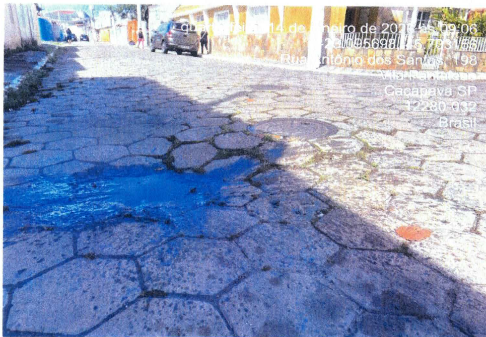
Foto 13: Local com afundamento na via próxima ao PV.
