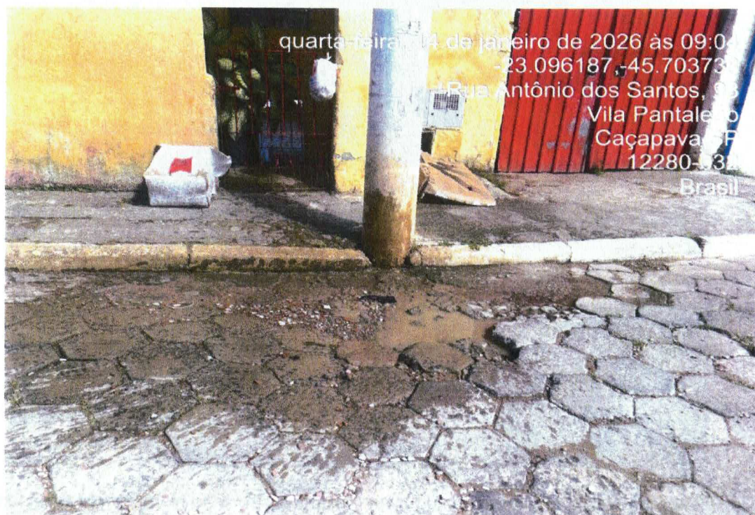
Foto 12: Local com afundamento na via em frente ao hidrômetro
