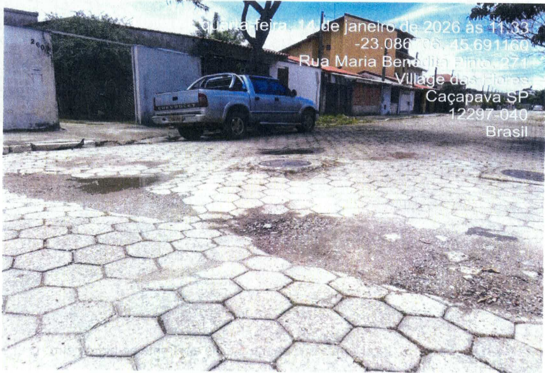
Foto 21: Local com afundamento na via em frente ao hidrômetro
