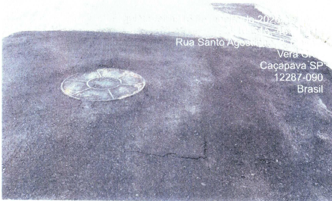
Foto 28: Fissuras ao redor da laje do PV
