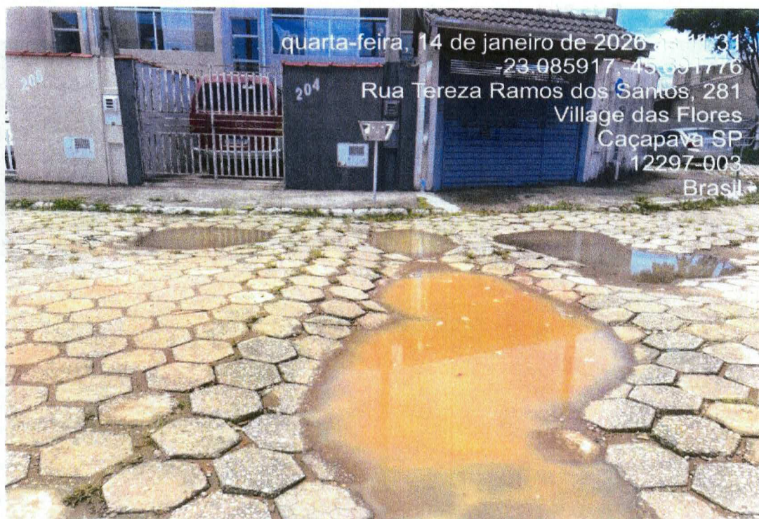
Foto 20: Local com afundamento na via em frente ao hidrômetro
