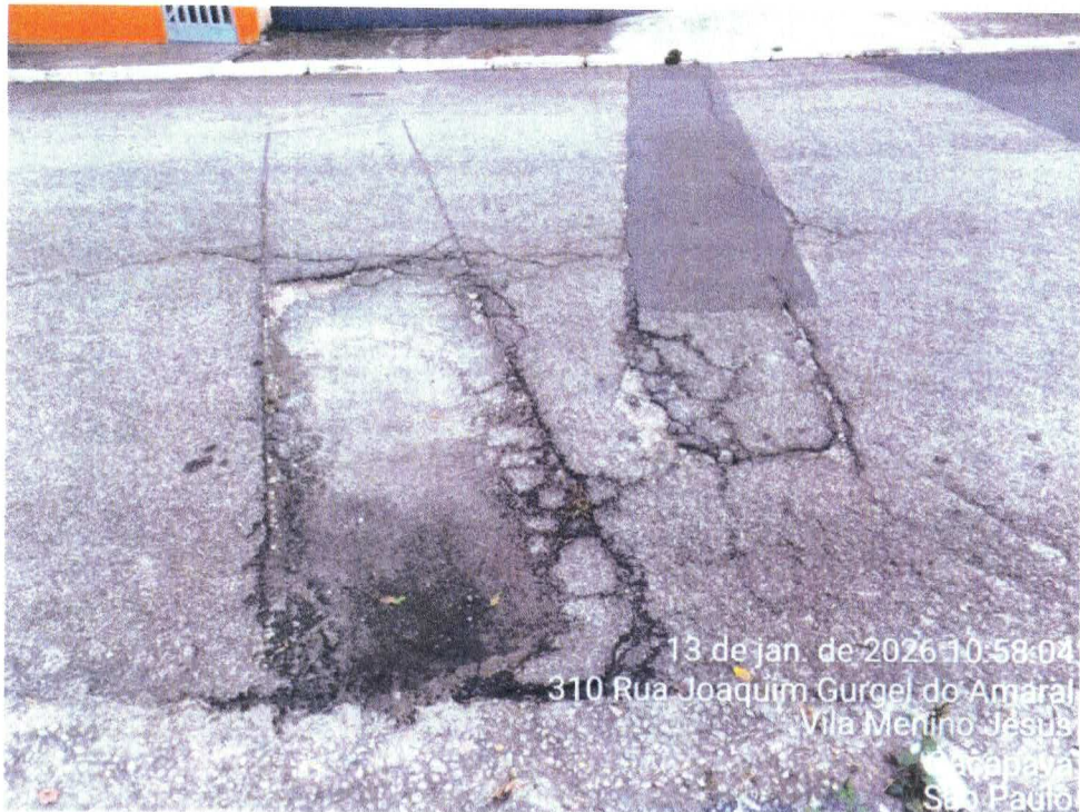
Foto 5: Deslocamento e fissuração do reparo realizado
