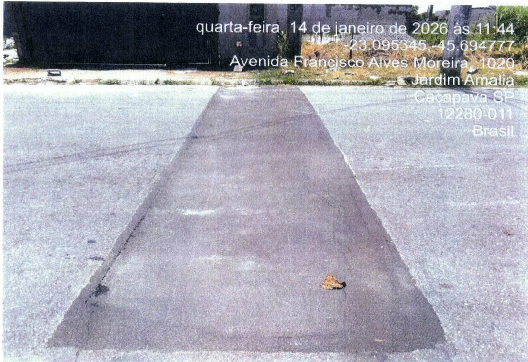
Foto 25: Local com afundamento na via em frente ao hidrômetro
