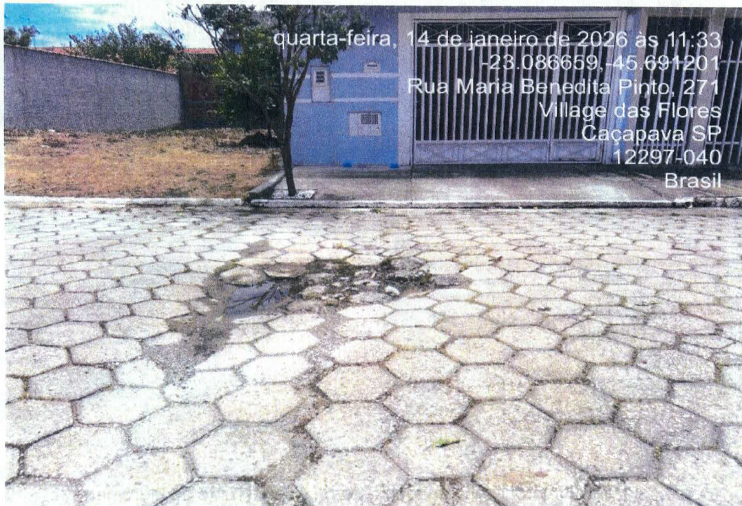
Foto 22: Local com afundamento na via em frente ao hidrômetro
