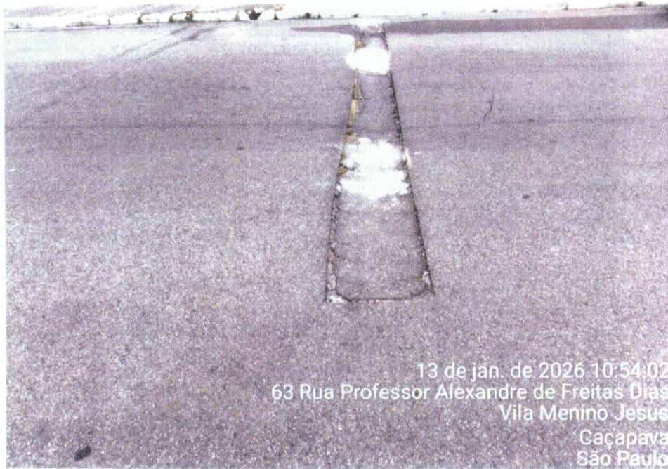
Foto 3: Local com afundamento em reparo realizado
