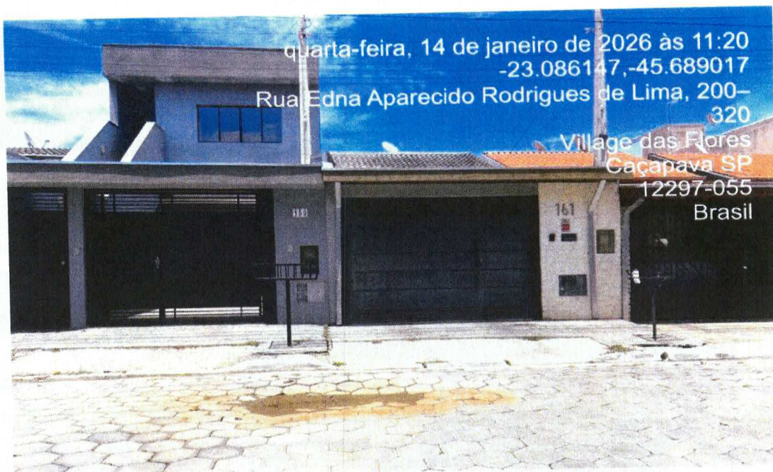
Foto 15: Local com afundamento na via em frente ao hidrômetro
