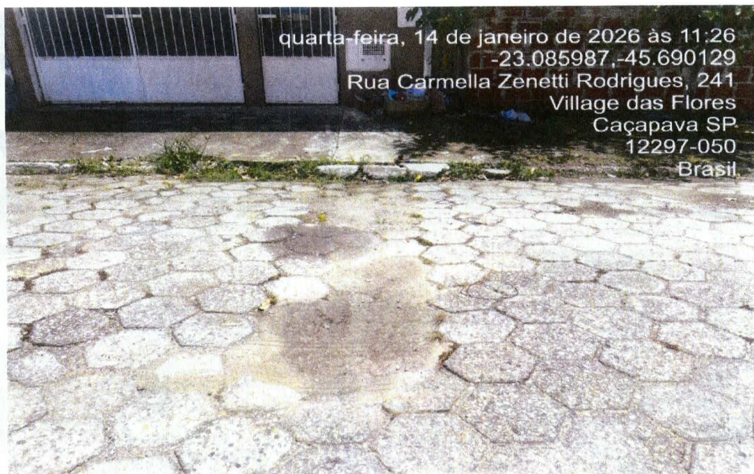
Foto 19: Local com afundamento na via em frente ao hidrômetro
